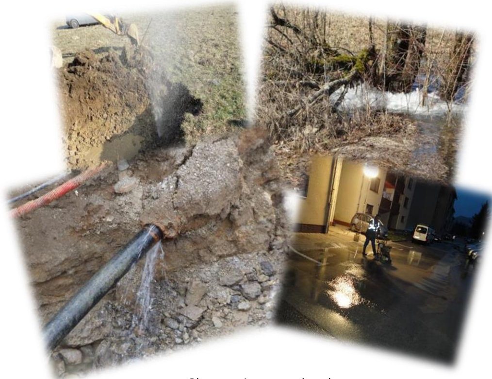
Okvare na javnem vodovodu
