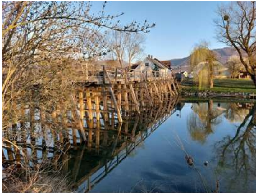
Slika 6: Porušena niveleta prekladne konstrukcije
