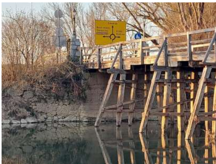
Slika 10: Poškodovan levobrežni mostni opornik
