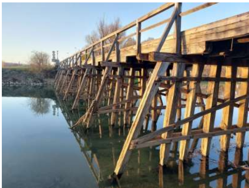
Slika 7: Dotrajani piloti mostu na območju pogoste oscilacije vode
