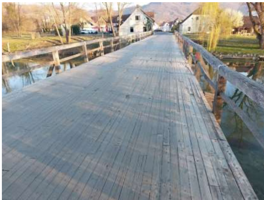
Slika 12: Poškodovan obrabni parket vozne površine
