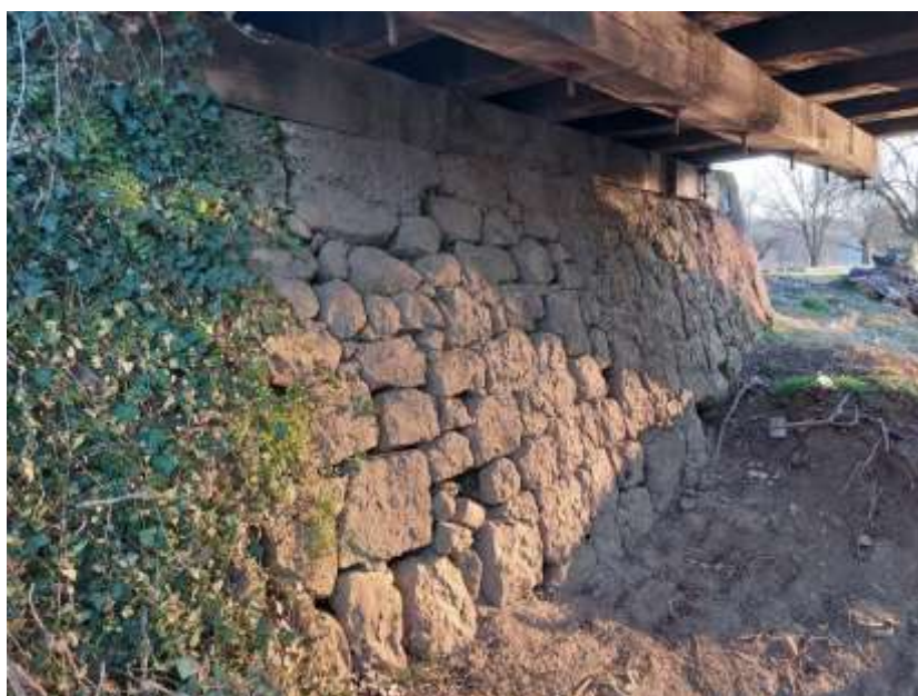
Slika 11: Poškodovan desnobrežni mostni opornik
