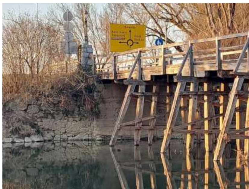
Slika 10: Poškodovan levobrežni mostni opornik
