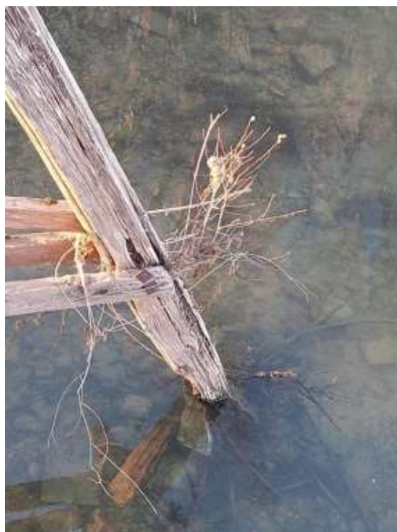
Slika 8: Dotrajani piloti mostu na območju pogoste oscilacije vode
