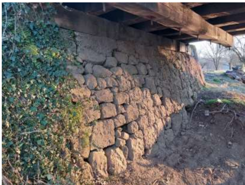
Slika 11: Poškodovan desnobrežni mostni opornik
