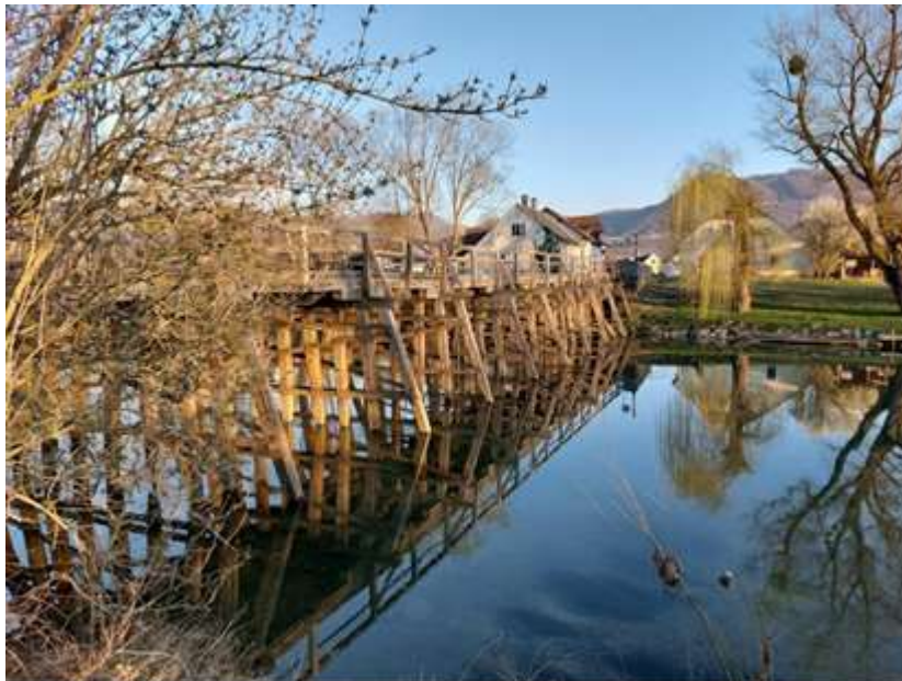
Slika 6: Porušena niveleta prekladne konstrukcije
