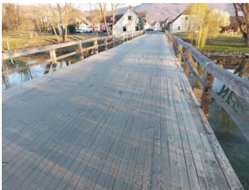
Slika 12: Poškodovan obrabni parket vozne površine
