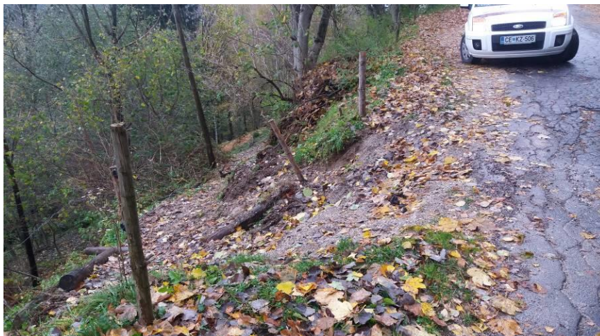
Slika 4: Poškodba bankine občinske ceste
