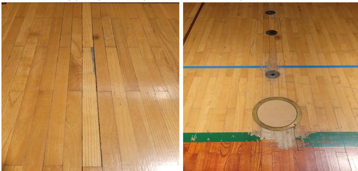
Slika 7, Slika 8: Dotrajan in poškodovan parket zaradi obrabe
