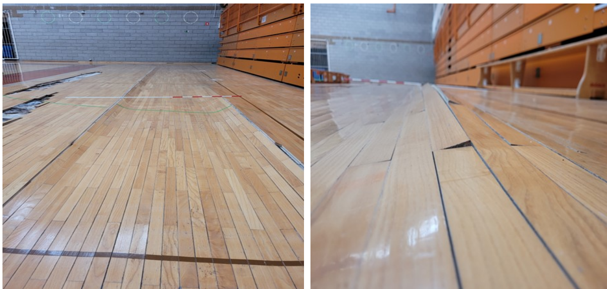
Slika 5, Slika 6: Dvignjen in poškodovan parket v dvorani zaradi izlitja vode
