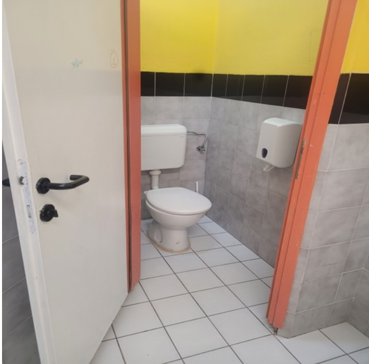
Slika 15: Dotrajana sanitarna oprema in notranja vrata
