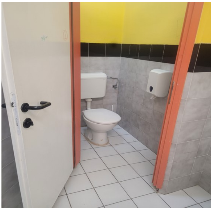
Slika 15: Dotrajana sanitarna oprema in notranja vrata
