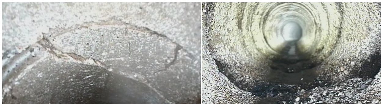
Poškodovana kanalizacijska cev
