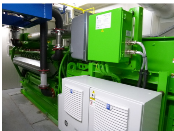
Oprema motor kogeneracijske enote SPTE 3
