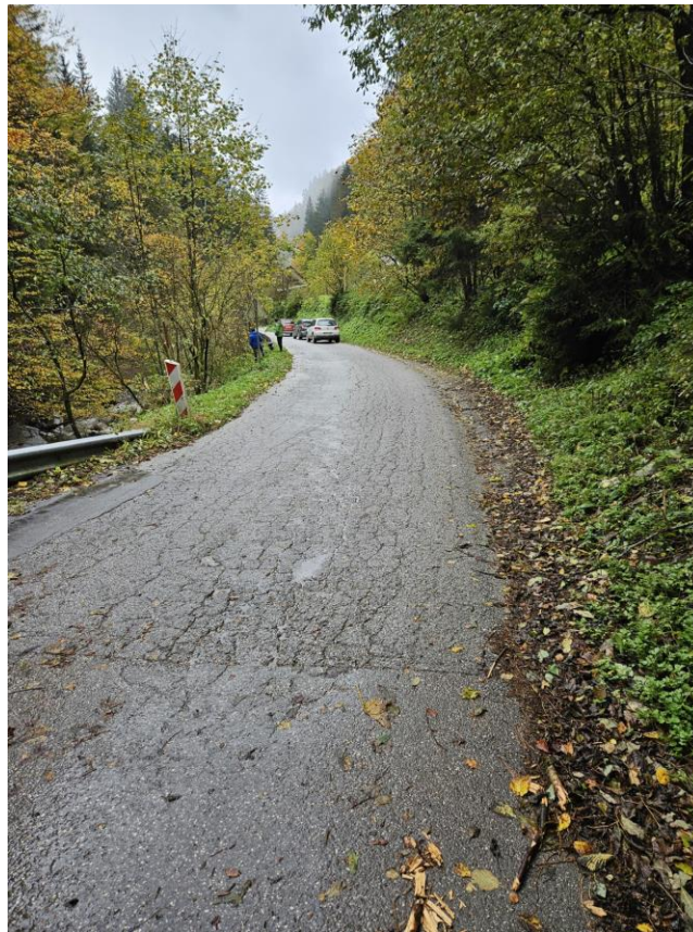
Slika 2: Prvotno stanje lokalne ceste 261071 Šentlenart - Zilc, ID 1230593
