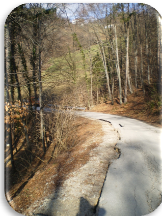
Slika 30: Poškodovano vozišče zaradi plazov
