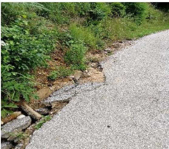
Poškodba ceste na Hočkem Pohorju
