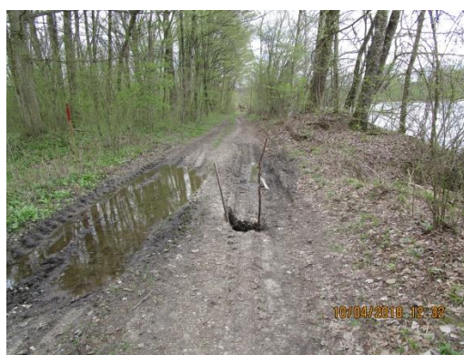
Slika 4; Poškodba občinske ceste
