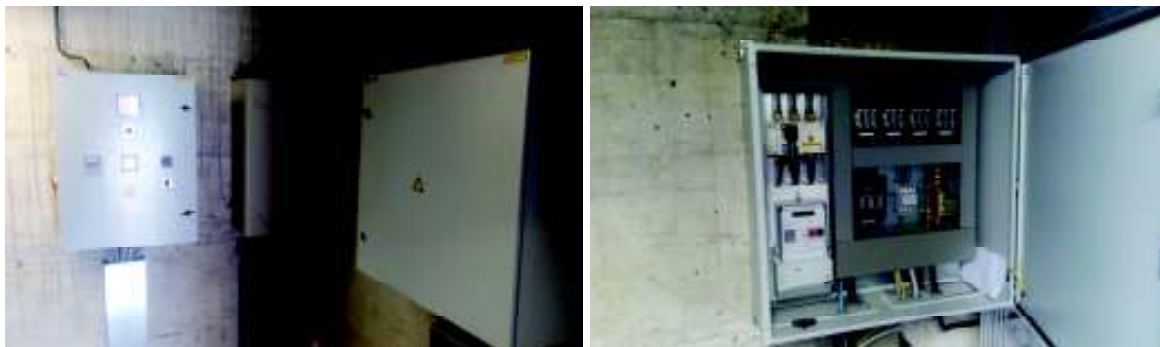
Nova elektro omara v črpališču Škratovina
