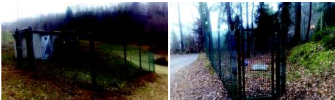
Nova vrata in ograja v sklopu ograje pri črpališču Retje in razbremenilniku Iskra
