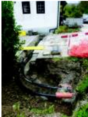
Trasa izpod cestišča
