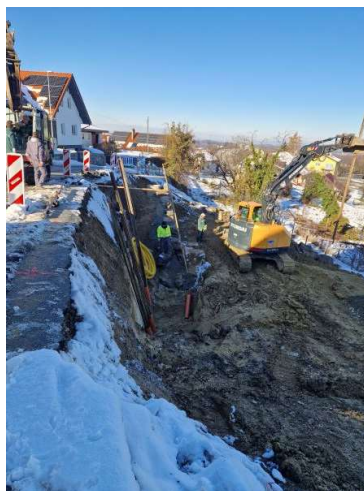
Slika 25: sanacija plazu na LC Cenkova-Cogetinci
