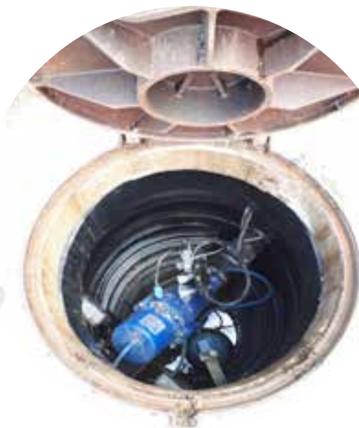
Jašek na podtlačni kanalizaciji
