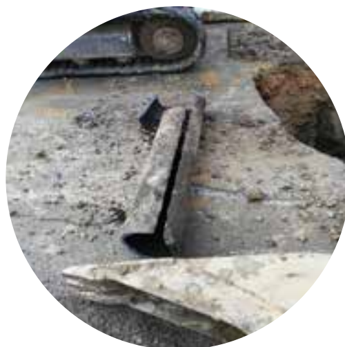
Poškodovana azbestna cev
