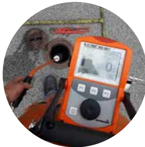
Pregled ventilov na distribucijskem omrežju
