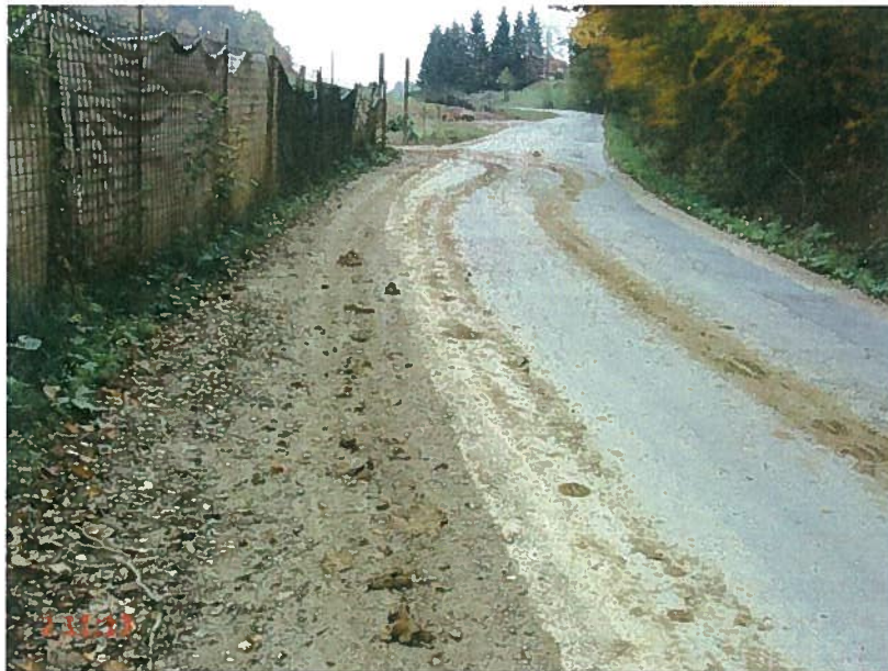
Slika 3: Onesnaženo cestišče občinske ceste.
