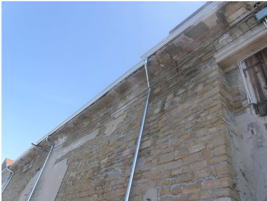
Zamenjani so bili žlebovi in odtoki s pocinkano pločevino skladno z navodili ZVKDS. Pocinkana pločevina ima daljšo obstojnost od barvane, sijoč lesk bo kmalu prekrila patina.
