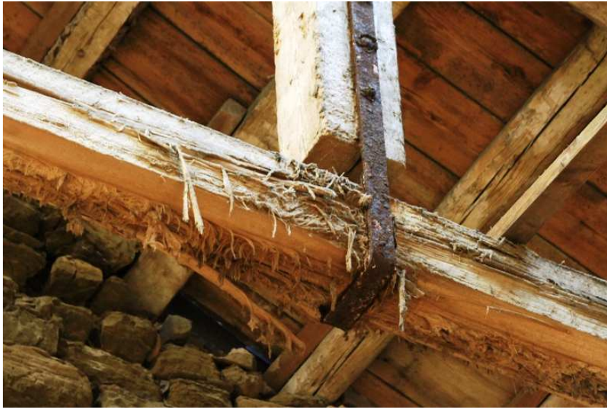
Kovinski spojni elementi so bili prekorodiani. V ozadju so vidni slabo povezani in izpadajoči kamni.
