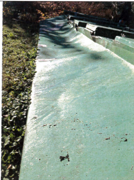
Slika 4: Stanje/poškodba zunanjega dela Precejalnika 3
