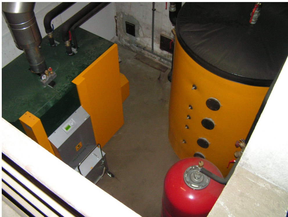
Slika prikazuje kotlovnico na lokaciji Kajuhova 2
