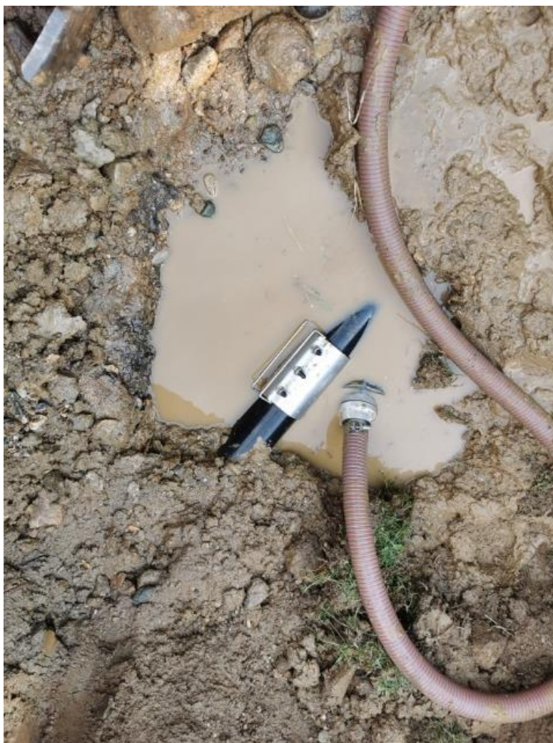
Slika 1: Okvara na cevovodu za podjetjem OVERLES, 2021
