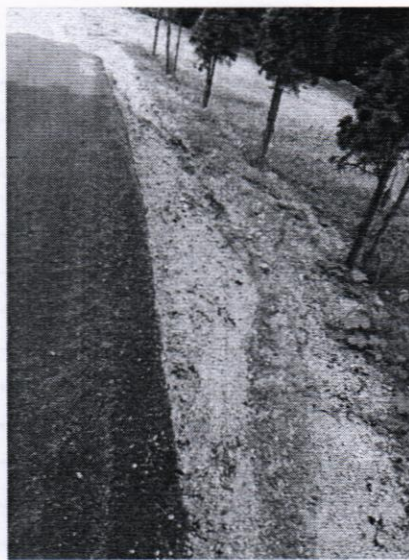
Poškodba bankine v naselju Kopivnik
