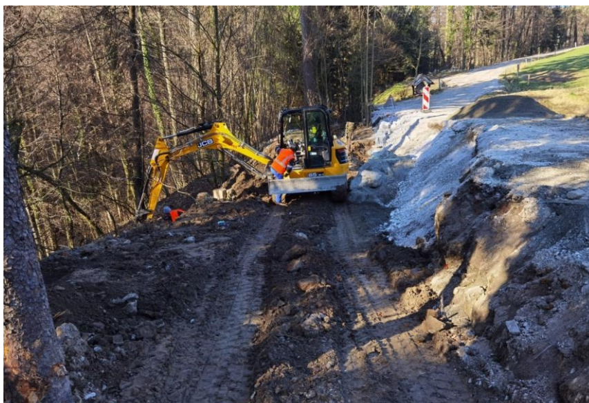
Sanacija plazu v Kočnem pri Polskavi
