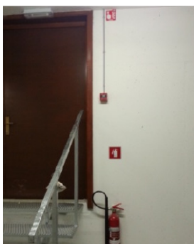
požarna oprema, stopnice
