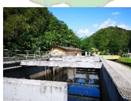
Centralna čistilna naprava
